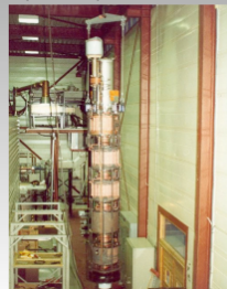
A 1.5-MW VHF klystron (224 MHz) at Tromsø.
